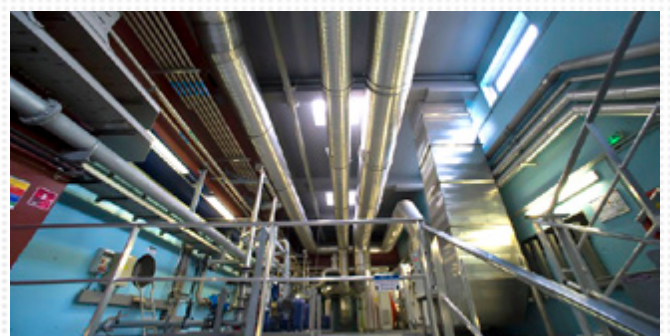
Collecteurs d'eaux usées
