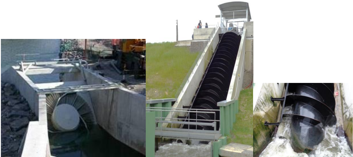
Turbine VLH (gauche, © MJ2 technologies) et vis d'Archimède (centre et droite, © pôle écohydraulique, OFB)
