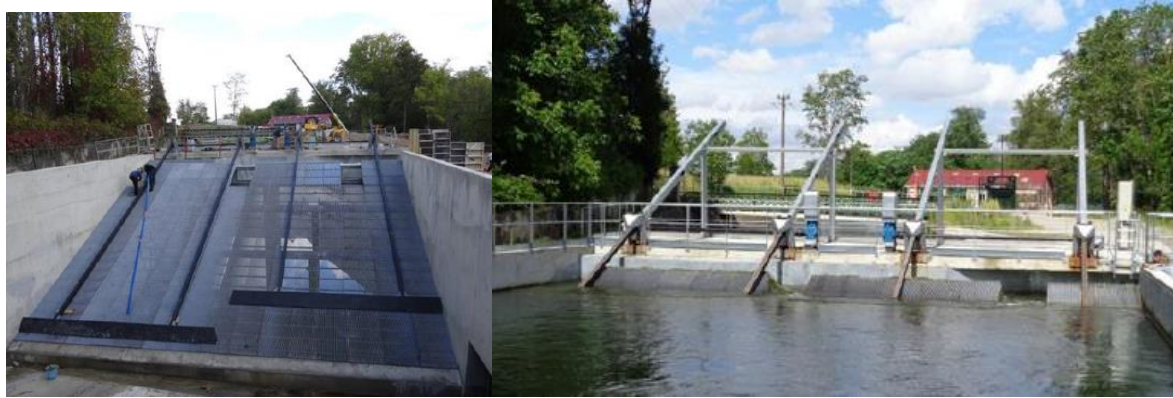
Exemple d'un plan de grilles incliné, à sec à gauche, en eau à droite (© pôle écohydraulique, OFB)
